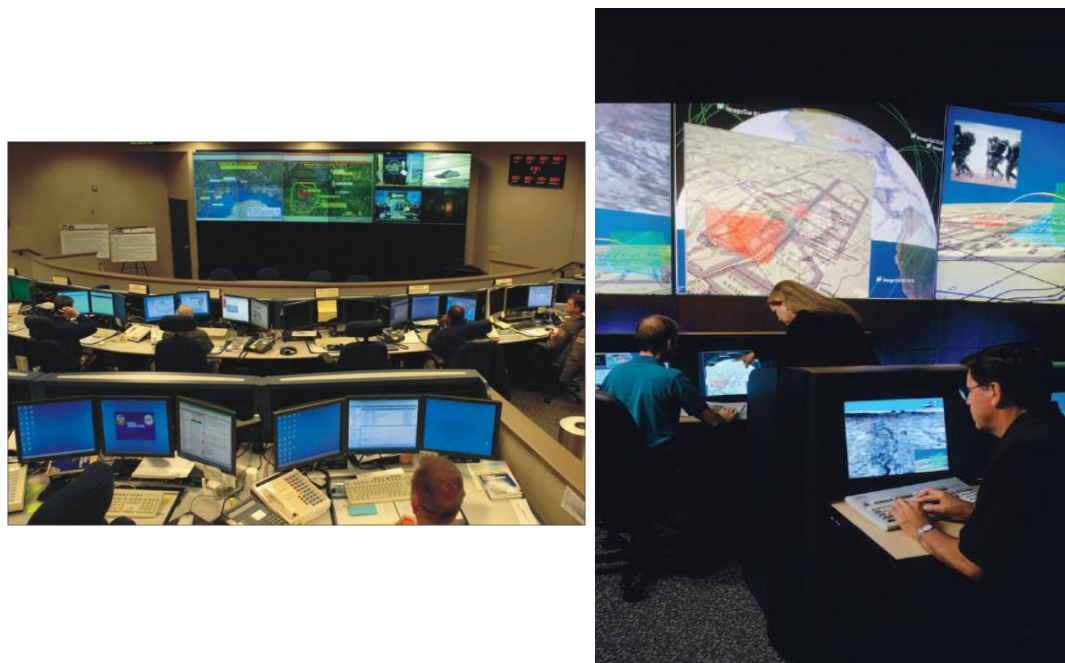
FIGURA 9: Ilustración de un centro de información y control, donde se recibe y procesa la información de todos sensores desplegados.
