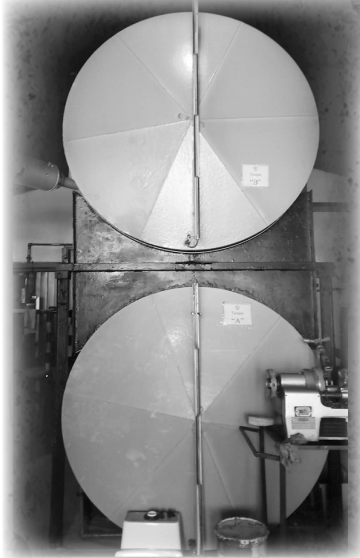
Cisternas para contención de Agua en la Usinas
