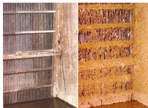
Fig. Reja de tamizado de agua de río limpia, cubierta por Limnoperna fortunei luego de 6 meses sin mantenimiento (Fuente: Atlas de Sensibilidad Ambiental de la Costa y el Mar Argentino)
